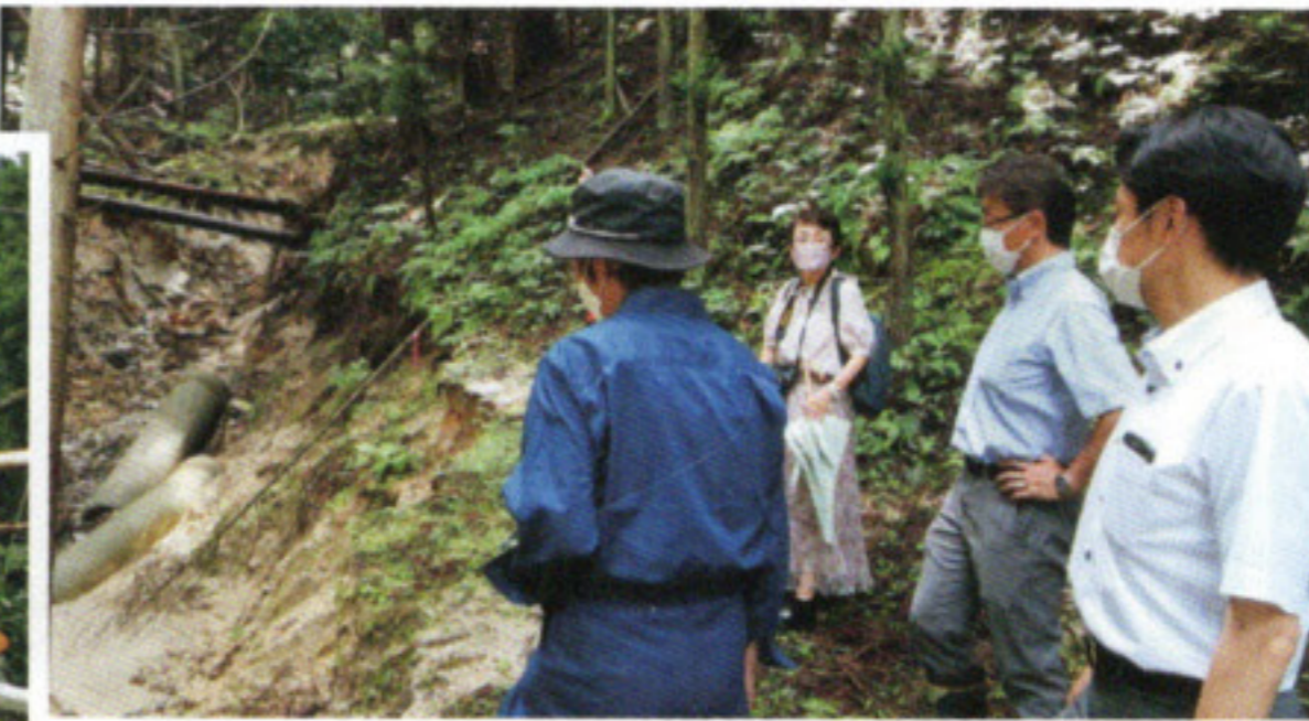
一乗寺松原町の土砂流出被害 2023・24年度に本格的治山工事をおこなう
