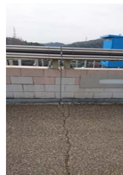
ダム天端の亀裂
