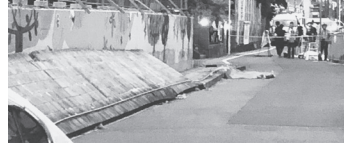
倒壊したブロック塀
