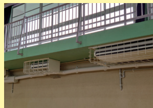
くすのき小学校・体育館に設置されたエアコン
