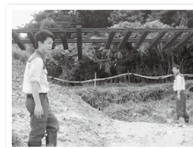
西日本豪雨でのKTR宮舞線の被害実態を現地調査
