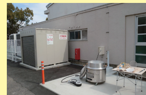
くすのき小学校・炊き出し設備
